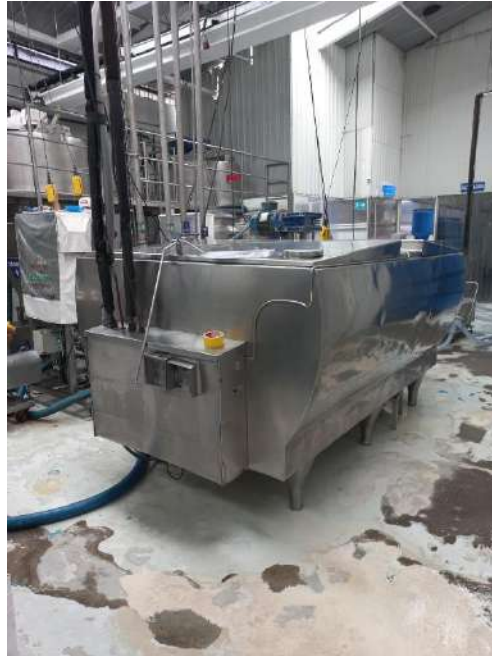
Ilustración 27-3: Tanque de enfriamiento
