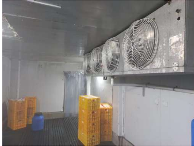
Ilustración 16-3: Cuarto frío para almacenamiento de producto terminado
