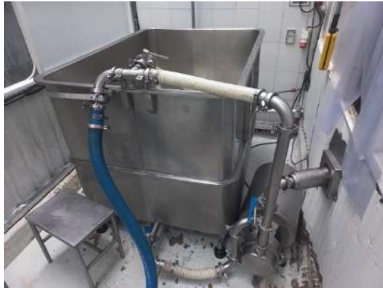
Ilustración 6-3: Tanque de almacenamiento de materia primera
