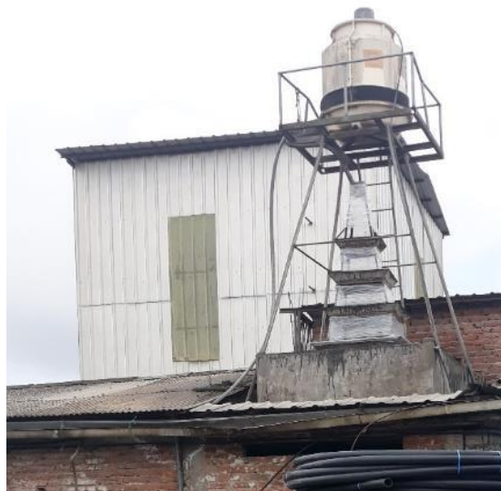
Ilustración 8-2: Torre de enfriamiento.
