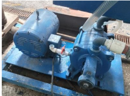
Ilustración 7-4: Bomba de vacío
