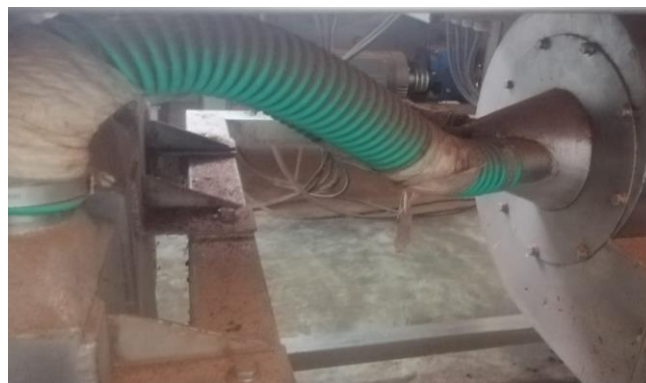
Ilustración 9-4: Mangueras de succión dañadas
