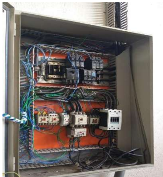
Ilustración 3-11: Cajetín eléctrico general
