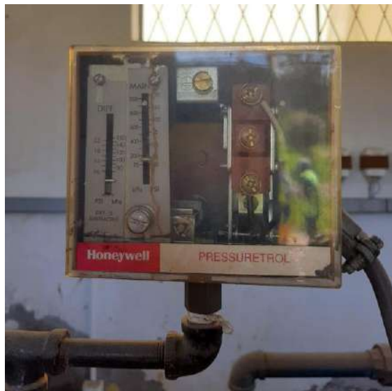
Ilustración 4-17: Seteo del pressuretrol
