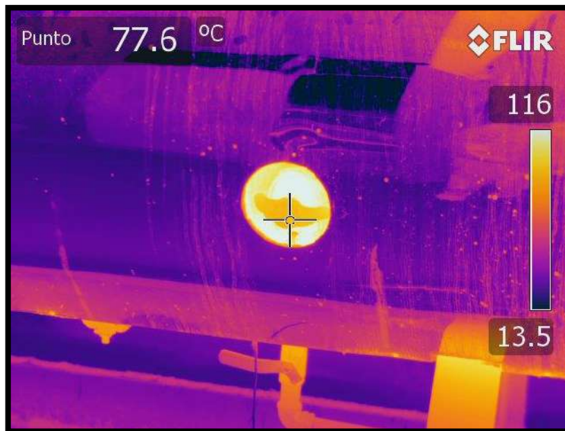
Ilustración 3-22: Imagen termográfica lateral
