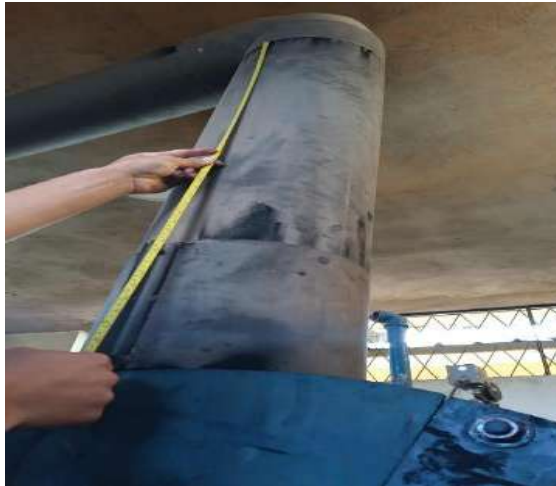
Ilustración 3-28: Medida de altura de la chimenea
