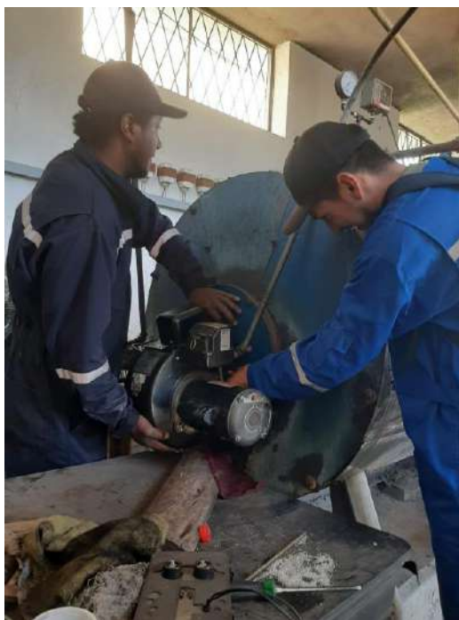
Ilustración 4-9: Calibración del ventilador
