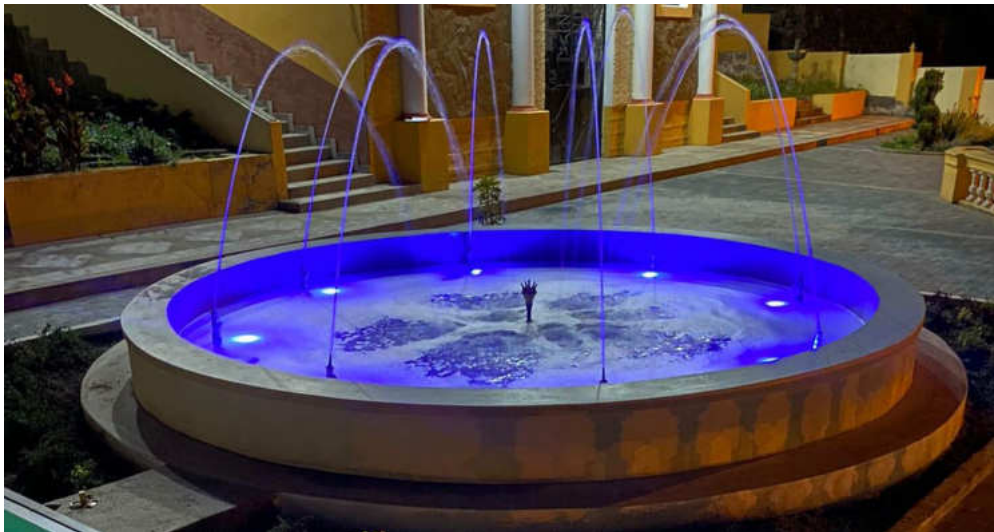
Ilustración 4-19: Funcionamiento sistema de iluminación, toberas del anillo externo Realizado por: Abarca M., Hernández L., 2023
