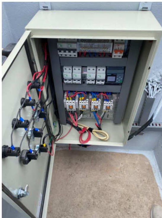
Ilustración 3-47: Interior del tablero de control Realizado por: Abarca M., Hernández L., 2023
