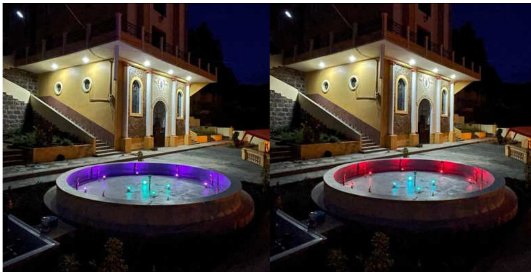
Ilustración 4-11: Prueba del sistema de iluminación anillo interno y externo
