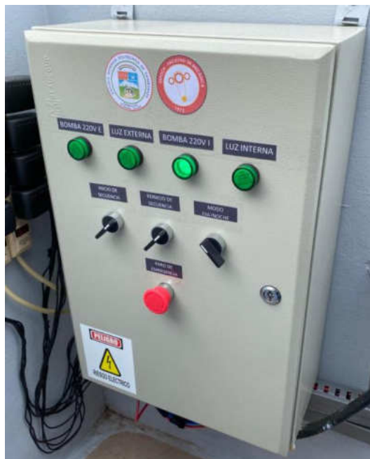
Ilustración 3-46: Exterior tablero de control Realizado por: Abarca M., Hernández L., 2023
