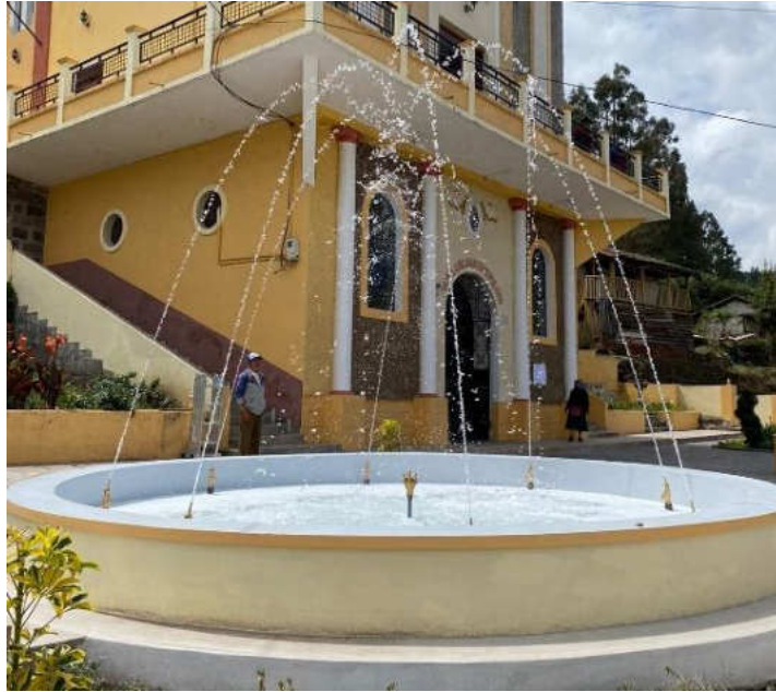
Ilustración 4-14: Prueba sistema de bombeo, anillo externo Realizado por: Abarca M., Hernández L., 2023
