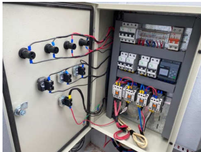
Ilustración 3-48: Cableado tablero de control Realizado por: Abarca M., Hernández L., 2023
