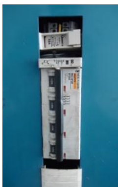
Figura V.70. Interruptores del Grupo Electrónico.
