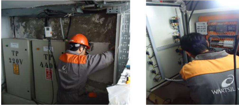
Figura III.42. Montaje del TTA.
