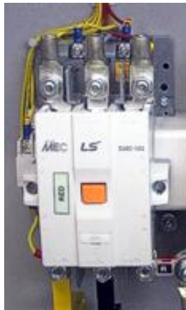
Figura III.22. Contactor conectado en un circuito de fuerza
