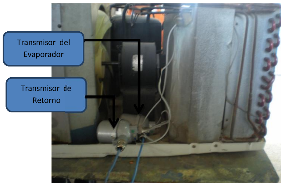
Figura V.115. Sensores de Temperatura montados en el Aire Acondicionado
