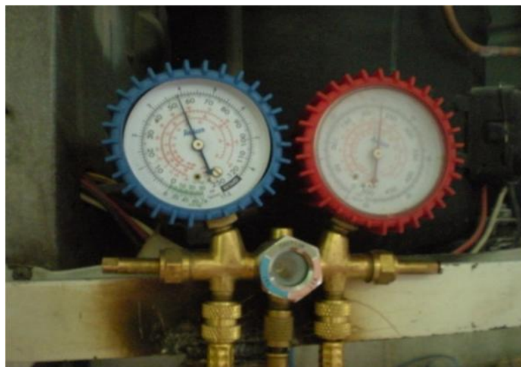
Figura V.129. Rangos de Presiones en el que trabaja correctamente el aire acondicionado
