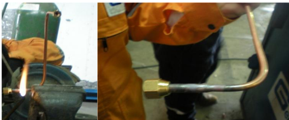
Figura V.119. Acople de tubería para el sensor de presión
