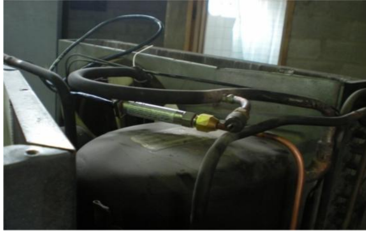
Figura V.120. Sensor de Presión en Tubería de Alta Presión
