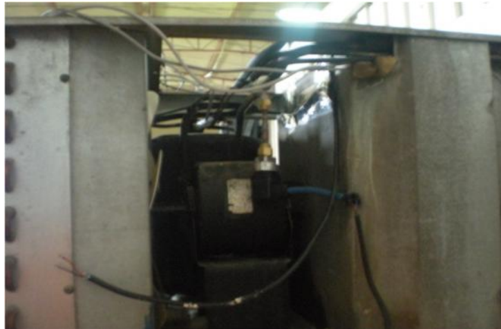
Figura V.121. Sensor de Presión en Tubería de Baja Presión
