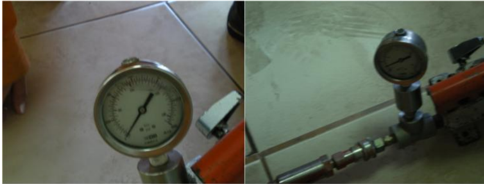
Figura V.104. Manómetro con presión en el sensor
