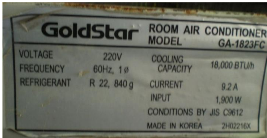
Figura V.100. Placa de datos del aire acondicionado
