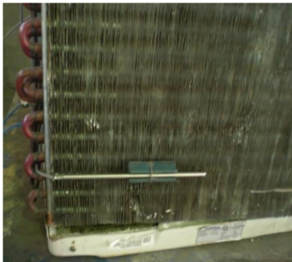
Figura V.113. Sensor en el Retorno del aire acondicionado
