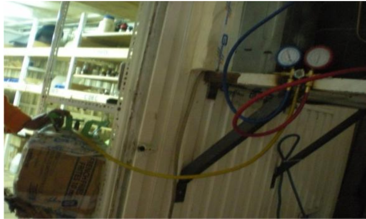
Figura V.126. Conexión Manómetros- Gas R22
