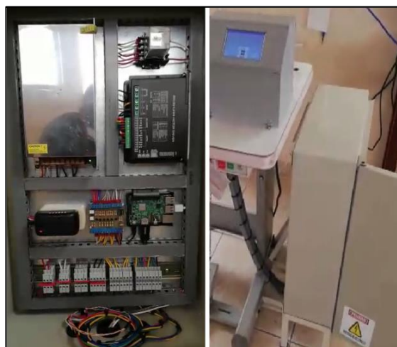
Figura 50-3. Cableado del sistema eléctrico del prototipo
