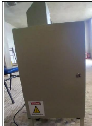
Figura 49-3. Vista frontal del gabinete instalado Realizado por: Remache Sagva, Edison, 2021.
