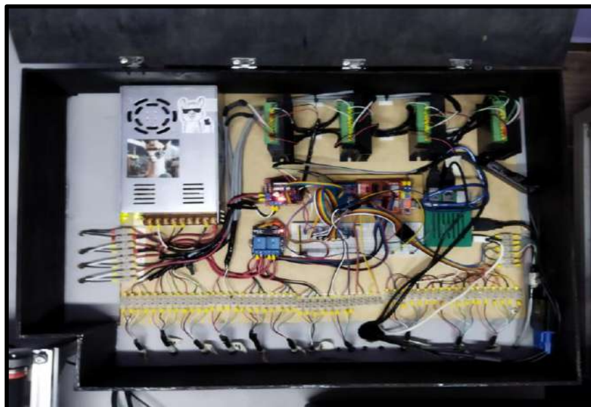
Ilustración 3-46: Tablero de control de la estación
