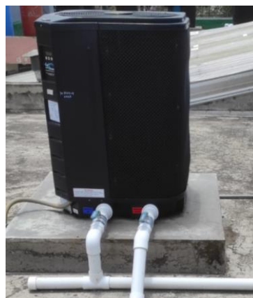
Ilustración 2-8: Bomba de Calor. Fuente: (SANDOROBOTICS, 2019)
