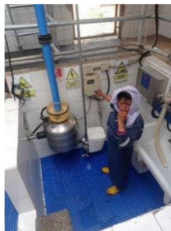
Ilustración 3-13: Sistema de Bombeo
