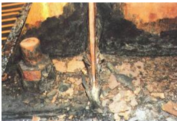
Ilustración 2-22: Pérdida de material por exfoliación
