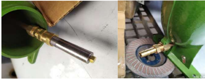
Figura 13-1: Tubería GLP de cobre en Blower Realizado por: CUEVA, Cristian, 2020.
