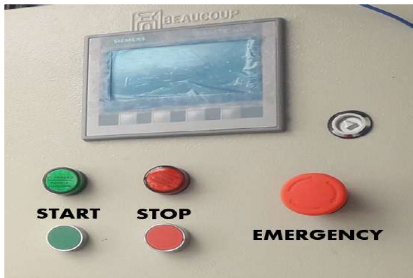
Figura 40-3: Control Principal del Deshidratador con botoneras y HMI Realizado por: CUEVA, Cristian, 2020.
