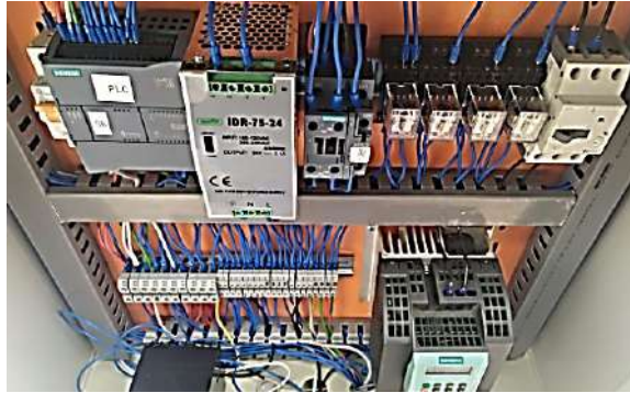
Figura 28-3: Tablero de control implementado Realizado por: CUEVA, Cristian, 2020.
