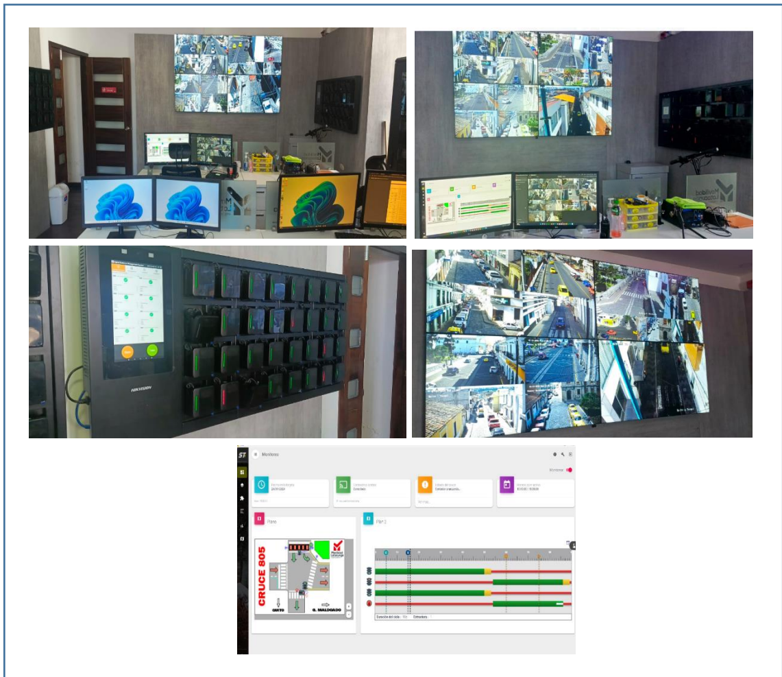
Figura 7-4: Funcionamiento de la central semafórica
