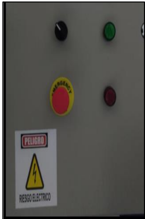
d. Tablero eléctrico del sistema MorAutomation
