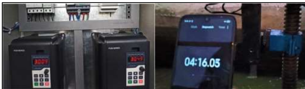
Figura 7-3: Tiempo de apertura y cierre de compuertas a frecuencia de 30 Hz.
