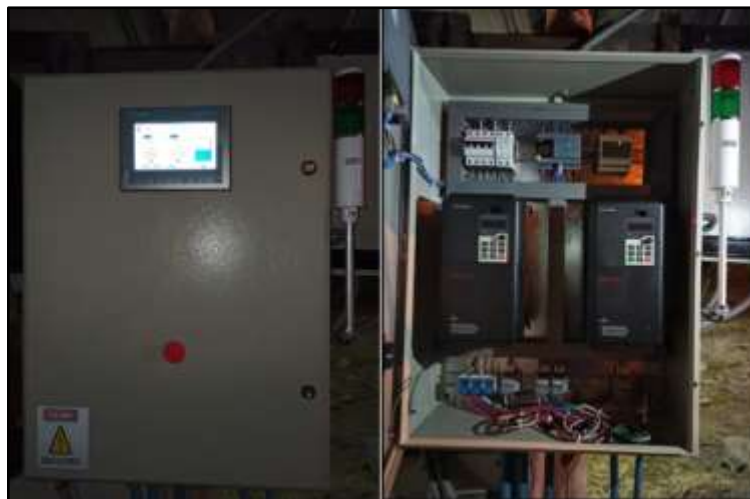
Figura 25-2: Vista frontal e interior del tablero
