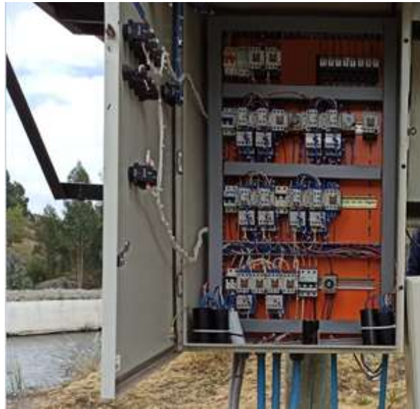
Figura 3-1: Tablero de control del sistema decadente
