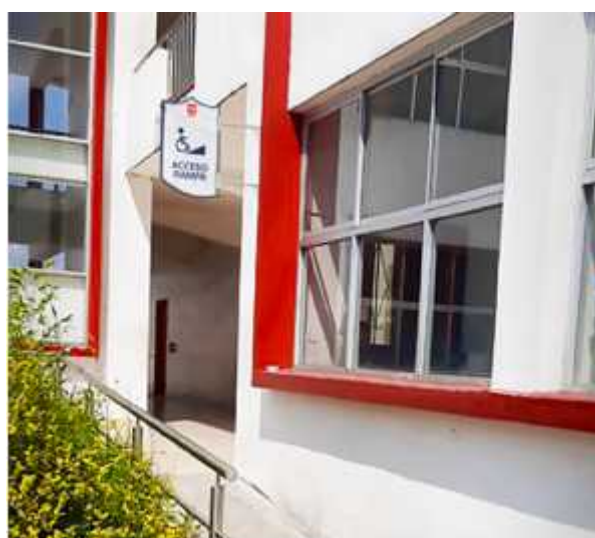
Ilustración 85-4: Señalética rampa accesible
