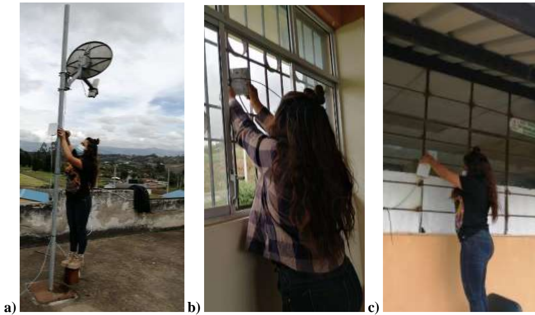
Figura 38-3: Instalación de las antenas, a) CPE1 b) CPE2 y c) CPE3
