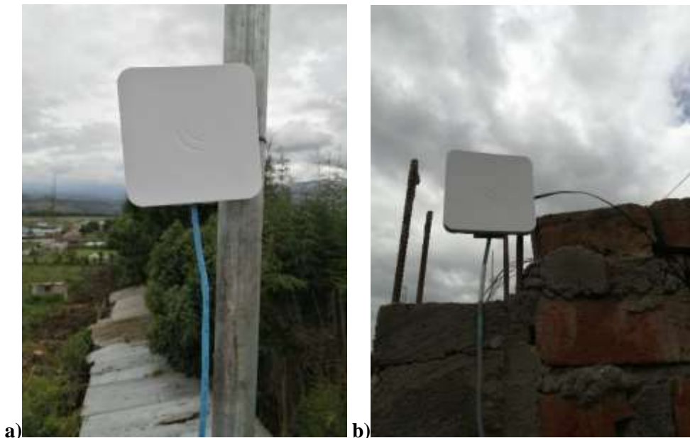
Figura 35-3: Instalación de las antenas Mikrotik SXTsq 5, a) en el mástil ubicado en el nodo Quimiag y b) en el CPE
