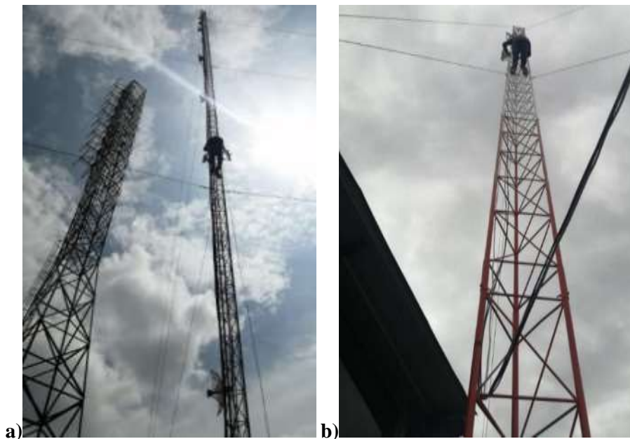
Figura 26-3: Instalación de las antenas Mikrotik LHG 5, a) en la torre ubicada en el cerro San Francisco y b) en la torre ubicada en el CPE
