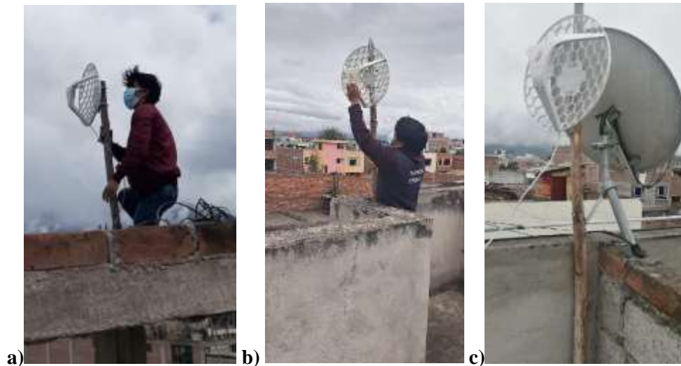
Figura 30-3: Instalación de las antenas, a) CPE1 b) CPE2 y c) CPE3.
