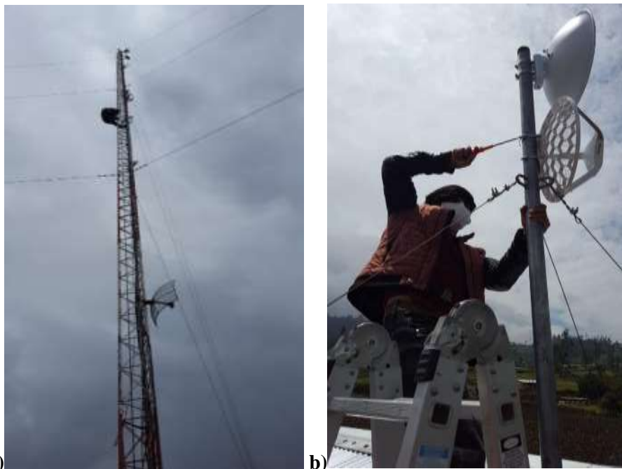
Figura 33-3: Instalación de las antenas Mikrotik LHG 5, a) en la torre ubicada en el Cerro San Francisco y b) Nodo Quimiag
