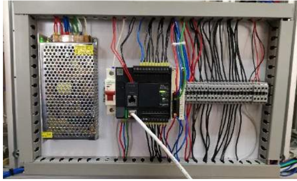
Figura 99-3: Tablero de control de la estación de mezclado.
