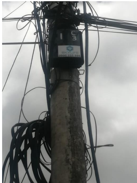
Figura 20-3: Modelo de caja NAPS instaladas en la red de Quimiag.
