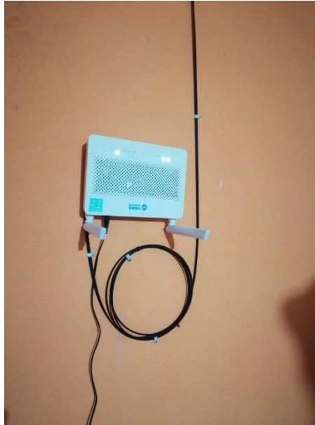
Figura 22-3: Equipo instalado al abonado.
