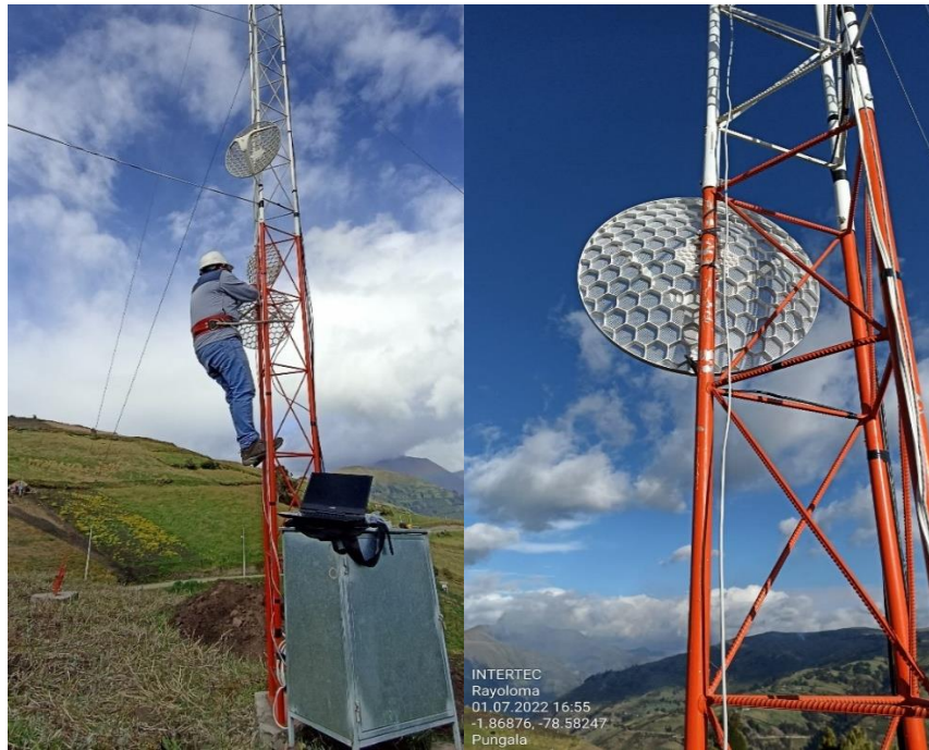
Ilustración 88-3: Colocación del BH-RAY_GLL y conexión hacia el router.
