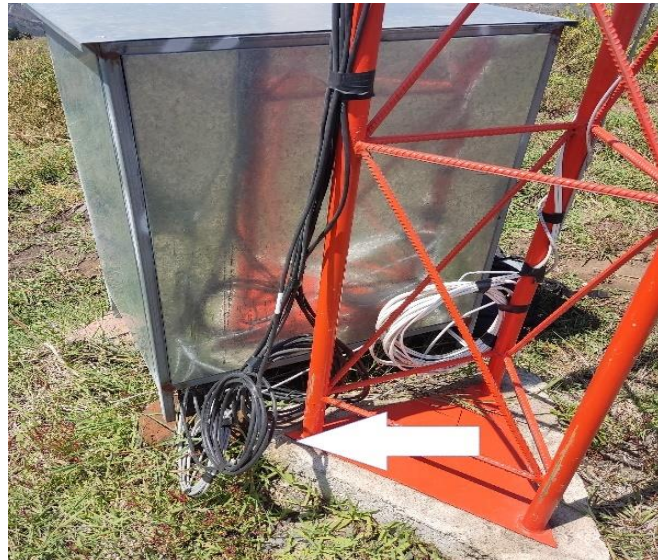
Ilustración 86-3: Reserva de cable FTP Cat 6, para la conexión al BH-RAY_GLL.
