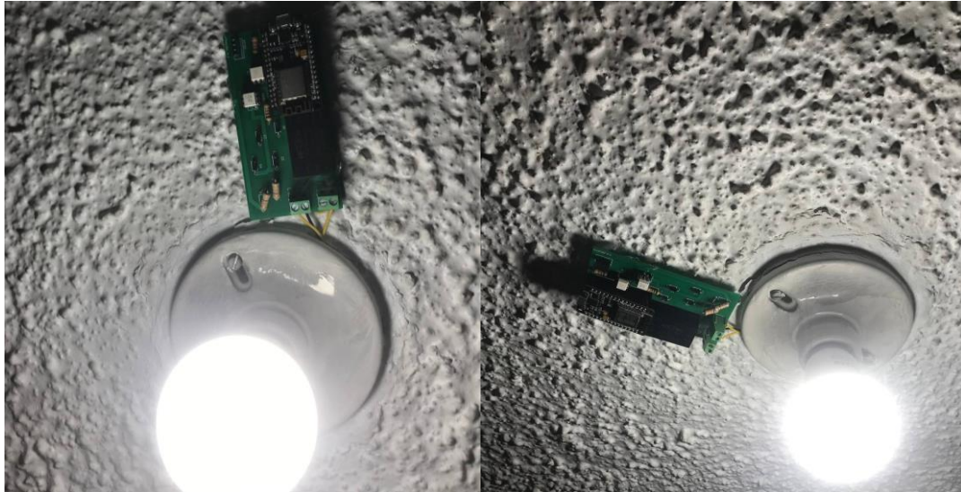
Ilustración 55-3: Implementación de dimmers en luminarias del cuarto máster.
