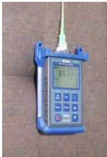
Ilustración 3-14: Valor de potencia en condiciones normales de la fibra 2.
