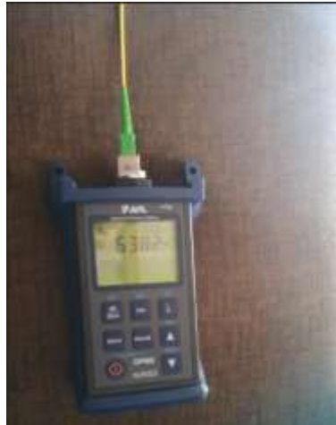
Ilustración 3-13: Valor de potencia en condiciones normales de la fibra 1.
