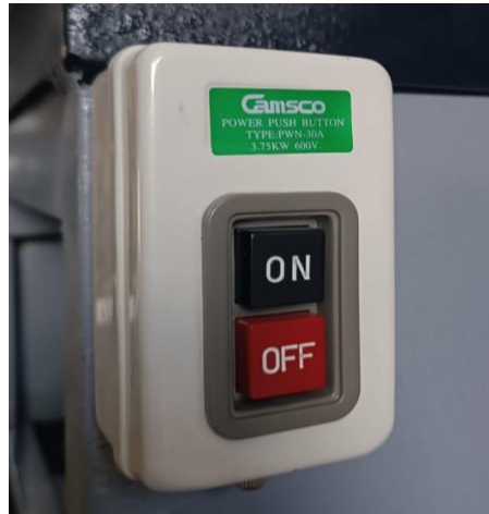
Ilustración 3-11: Caja de control.
