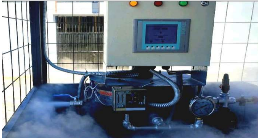
Ilustración 3-51: Prueba 1 válvula de vapor totalmente abierta
