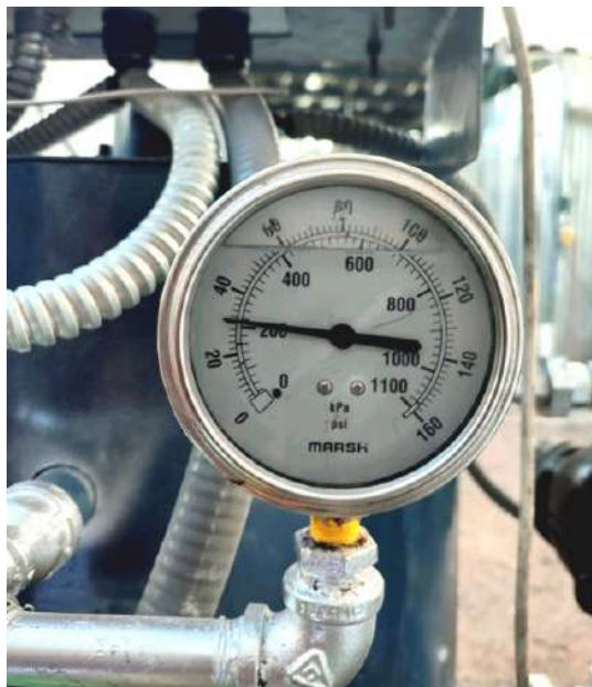
Ilustración 3-44: Presión de funcionamiento del manómetro Realizado por: Colcha F., Tonato J., 2023.
