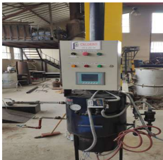
Ilustración 3-22: Caldero piro-tubular Realizado por: Colcha F., Tonato J., 2023.
