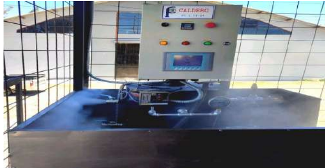
Ilustración 3-53: prueba 3 válvulas de vapor un cuarto abierto
