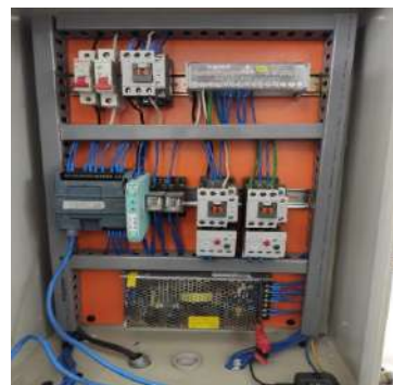
Ilustración 3-10: Panel de control
