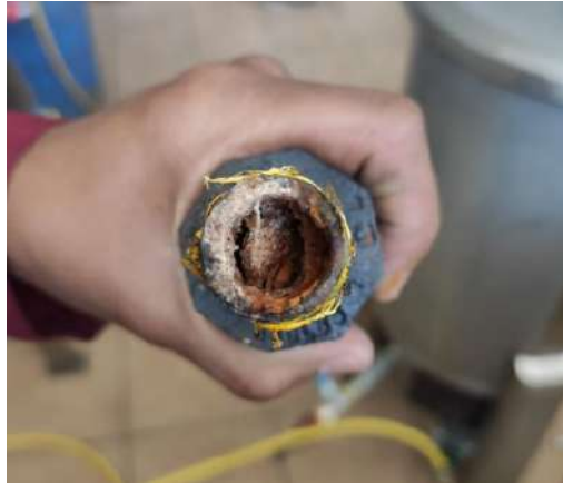
Ilustración 3-5: Tubería de entada de agua
