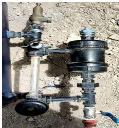
Ilustración 3-4: Control de nivel de agua
