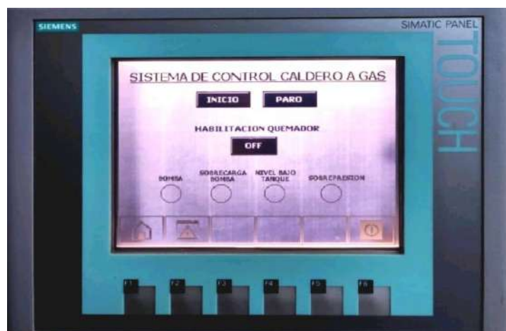
Ilustración 3-40: Interfaz de control del caldero
