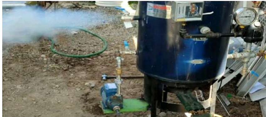
Ilustración 3-47: Generación de vapor de trabajo en el caldero
