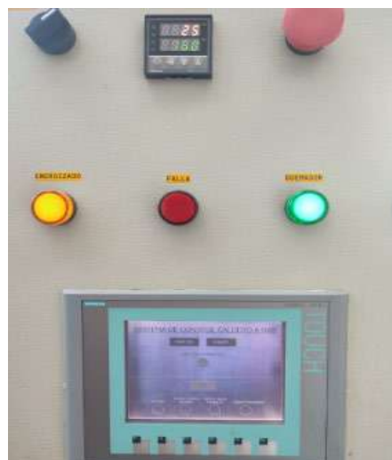
Ilustración 3-42: Interfaz en funcionamiento de pantalla de control del caldero Realizado por: Colcha F., Tonato J., 2023.
