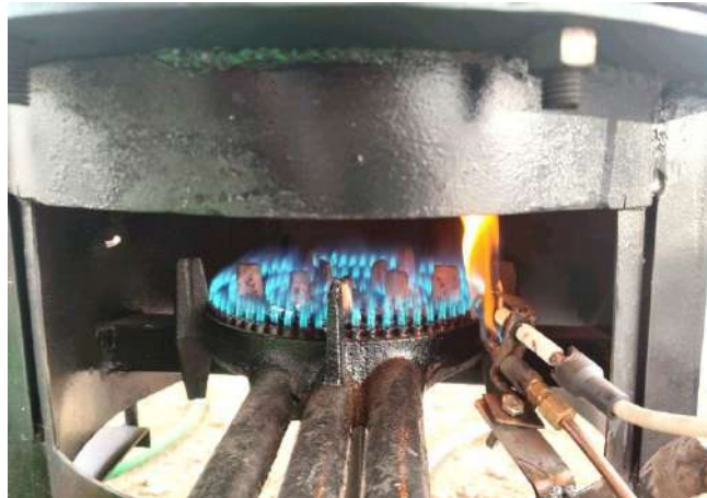
Ilustración 3-43: Funcionamiento del quemador de gas Realizado por: Colcha F., Tonato J., 2023.
