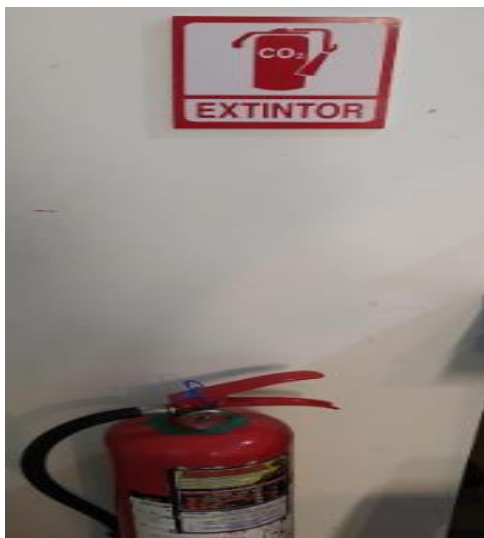
Señalética del extintor de incendios
