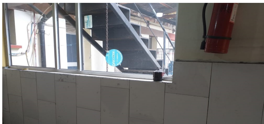
Ilustración 11-4: Mejoramiento de las condiciones de la pared del servicio de farmacia Realizado por: Tamami, Diana, 2023.
