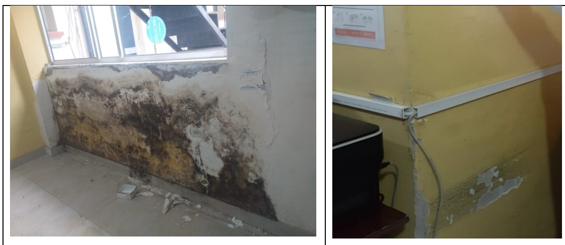
Ilustración 3-4: Presencia de humedad en las paredes
