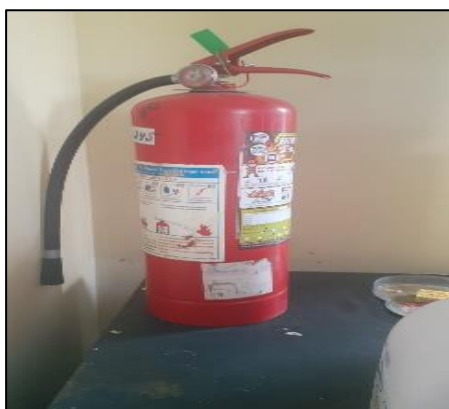
Ilustración 3-4: Extintor de incendios
