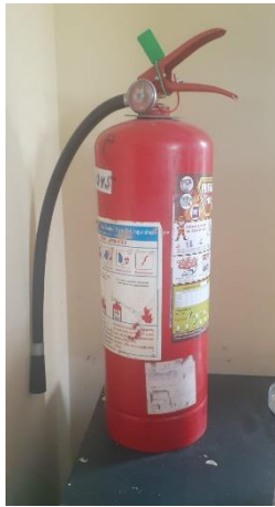
Extintor no se encuentra en lugar fijo
