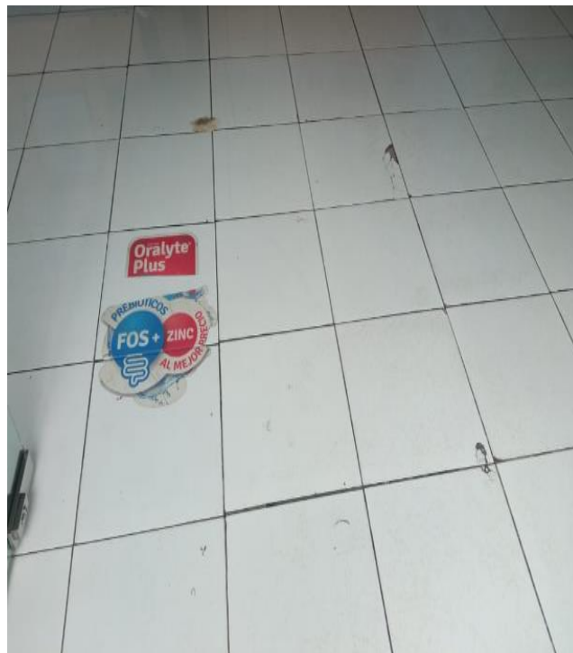
Ilustración 4-2: Piso de la farmacia desgastado
