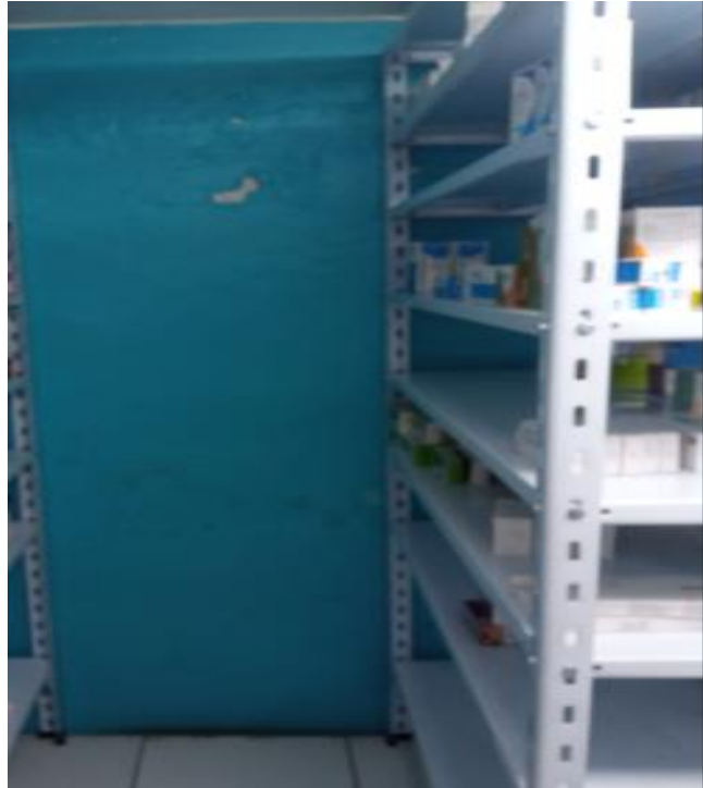
Ilustración 4-3: Paredes manchadas y desgastadas
