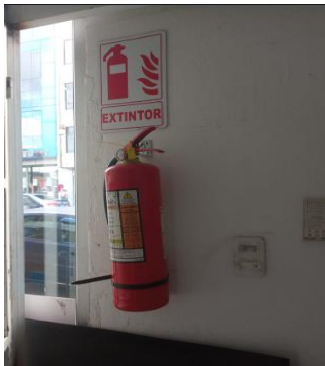
Ilustración 4-26: Etiqueta del extintor de incendios
