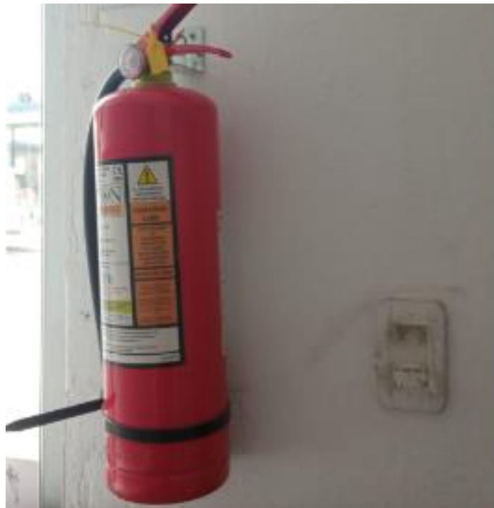
Ilustración 4-21: Extintor de incendios sin señalética
