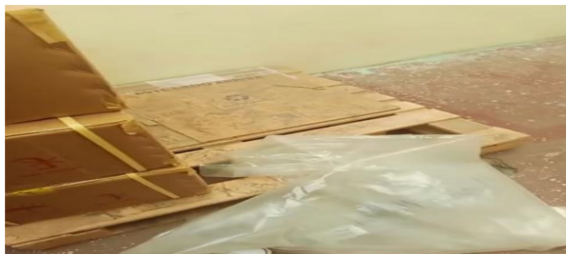
Ilustración 4-8: Estado del piso de bodega de insumos médicos
