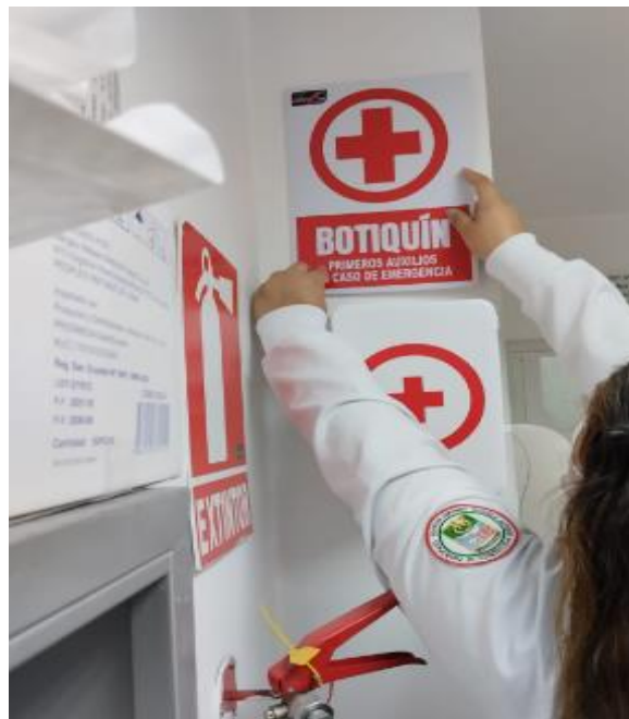
Ilustración 4-17: Instalación de botiquín de primeros auxilios
