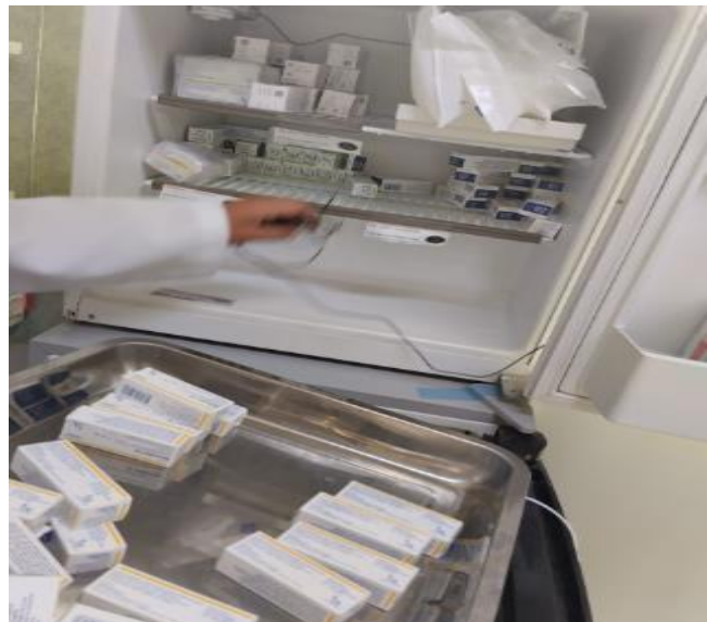
Ilustración 4-11: Falta de mantenimiento del refrigerador
