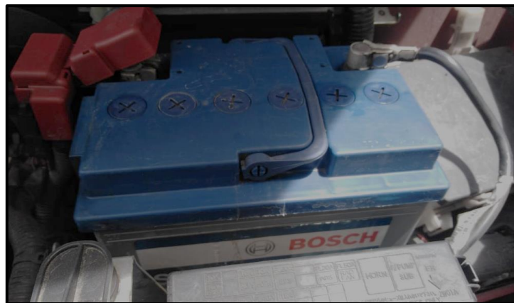
Figura 10-2: Batería de 12 V dentro del vehículo
