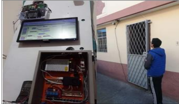
Figura 1-3: Implementación de módulo de seguridad en la vivienda.
