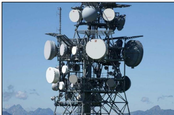
Figura 6-1: Antenas parabólicas - microondas
