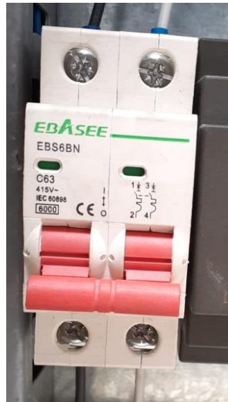
Figura 17 - 2. Interruptor termomagnético general.
