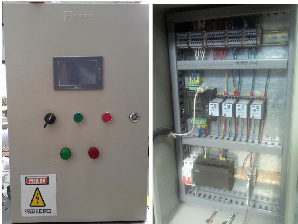
Figura 19 - 2. Fotografía de tapa y parte interna del tablero de control. Realizado por: Sangucho F. y Saavedra E., 2020.
