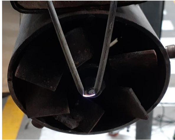
Figura 2 -3. Prueba de funcionamiento de la chispa de ignición en modo manual. Realizado por: Sangucho F.y Saavedra E., 2020.
