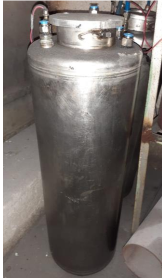
Figura 21 - 2. Tanque de combustible Realizado por: Sangucho F. Saavedra E. 2020.
