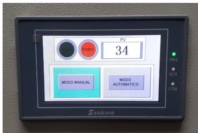
Figura 1 -3. Prueba de funcionamiento de la pantalla HMI.
