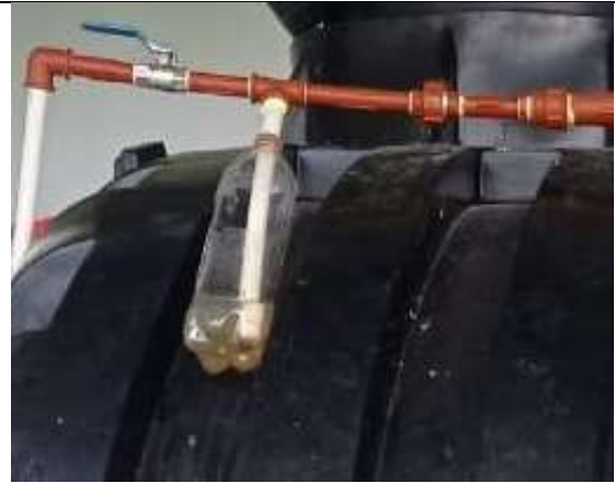
Trampa de agua
