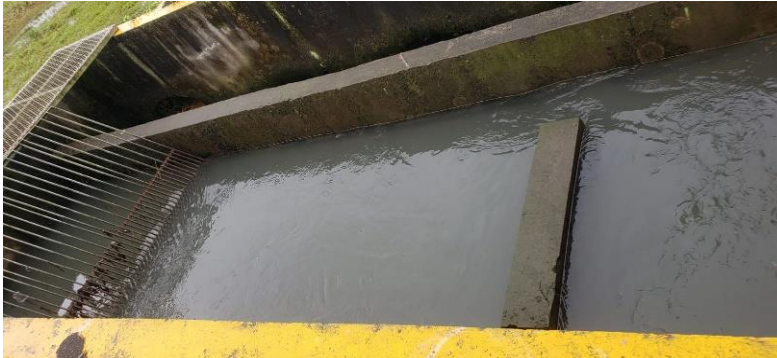
Ilustración 1-2: Entrada de agua residual a la PTAR de Macas
