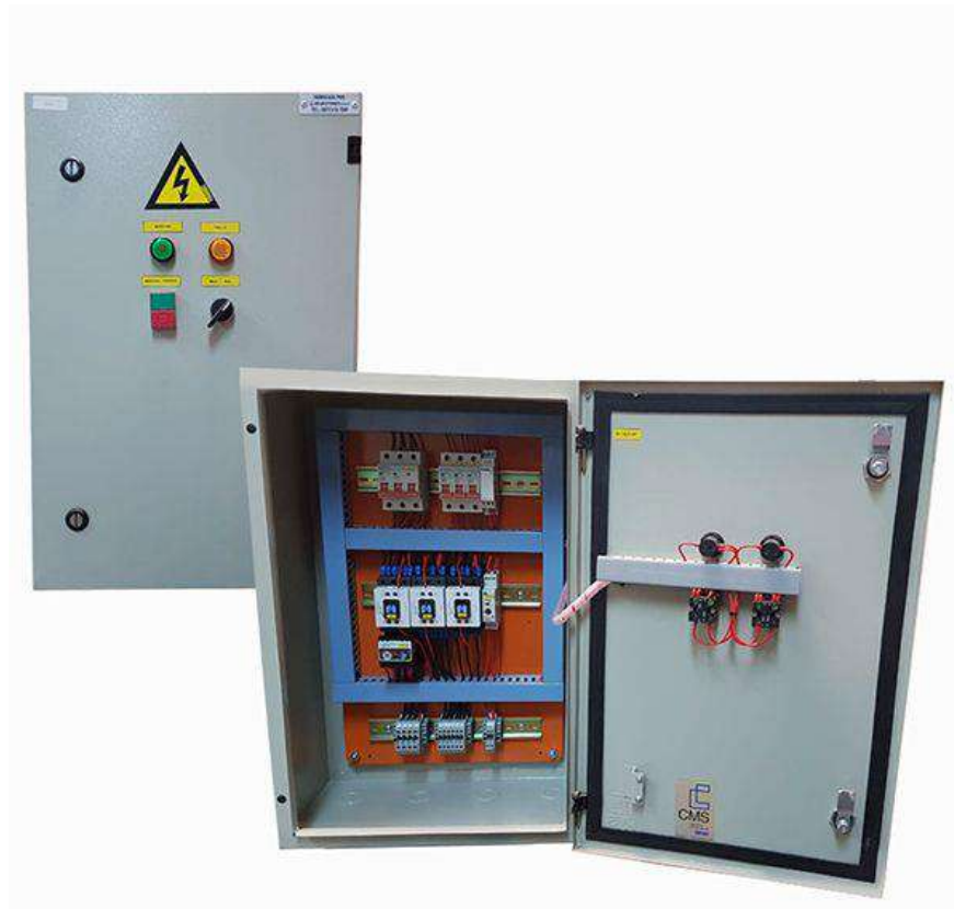
Figura 12-2: Ejemplo de tablero eléctrico con dispositivos de lógica cableada
