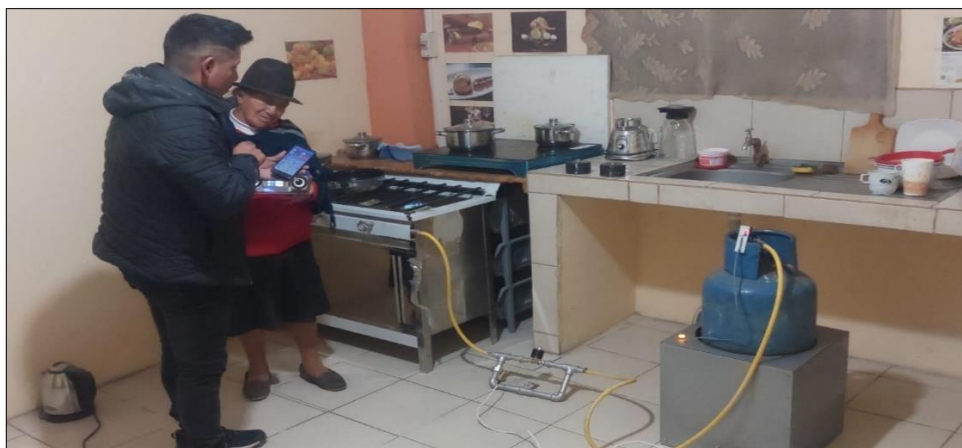
Ilustración 27-4: Comprobación de la comunicación del sistema Antifugas
