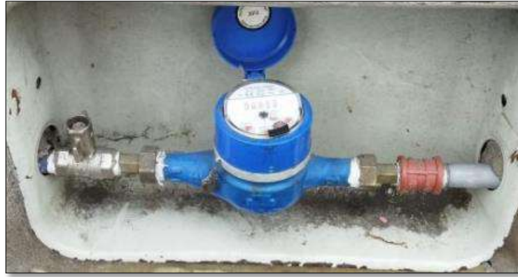
Figura 2-5: Medidor Zenner instalado en la ciudad de Riobamba.
