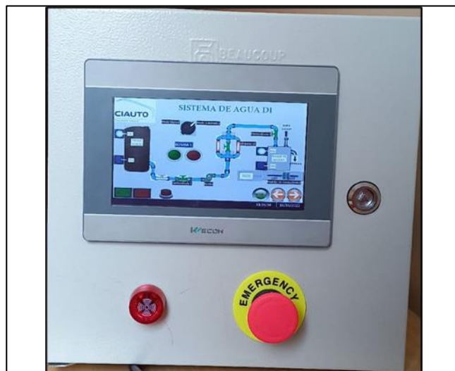
Ilustración 1-4: Vista externa del tablero de control
