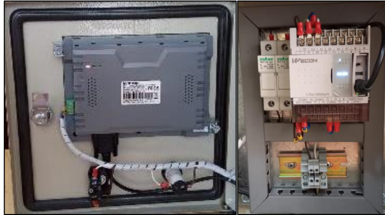
Ilustración 2-4: Vista interna del tablero de control
