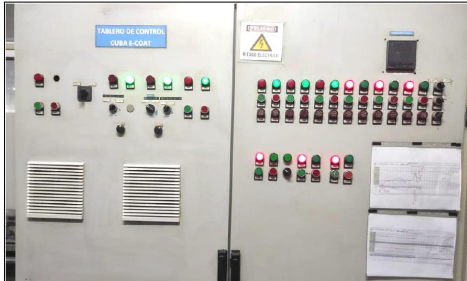
Ilustración 9-2: Tablero de control “CUBA E-COAT” actual
