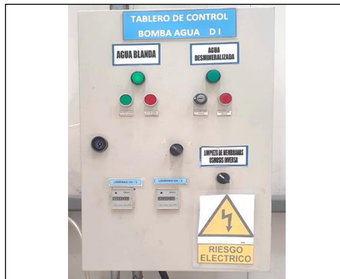
Ilustración 10-2: Tablero de control “BOMBA AGUA DI”
