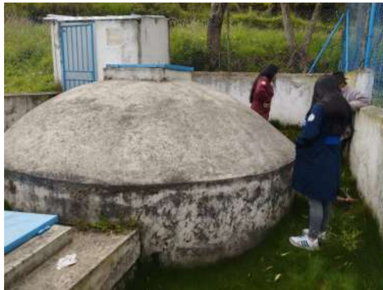
Ilustración 3-4: Tanque de almacenamiento
