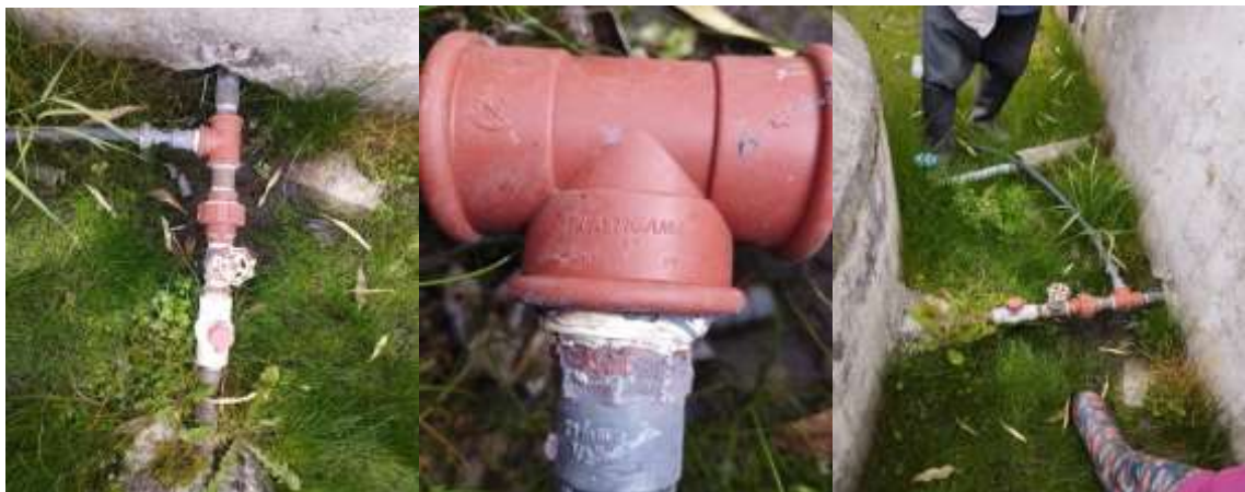
Ilustración 3-3: Tuberías de conexión de la captación al tanque de almacenamiento
