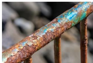
Ilustración 2-1: Corrosión del acero
