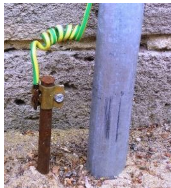
Ilustración 2-9: Varilla de cobre para puesta a tierra
