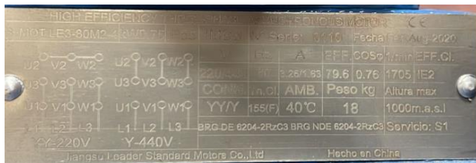
Ilustración 3-31: Placa- Motor trifásico LEADER
