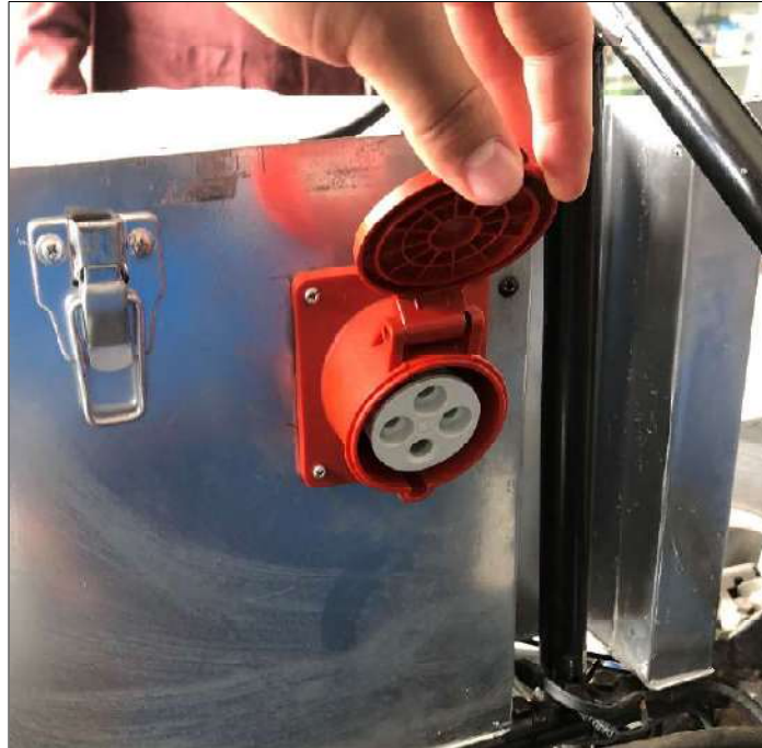
Ilustración 3-30: Puerto hembra en contenedor de baterías
