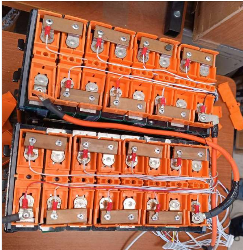
Ilustración 3-27: Conexión en serie de módulos con sus respectivos cables para BMS
