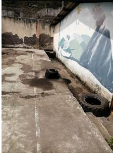
Ilustración 4-12: Derrames de aceite en el suelo del patio de Bayushig
