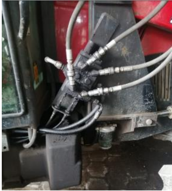
Ilustración 4-17: Presencia de fluido hidráulico en las cañerías
