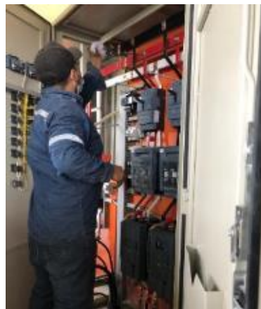
Ilustración 2-10: Mantenimiento preventivo de tableros
