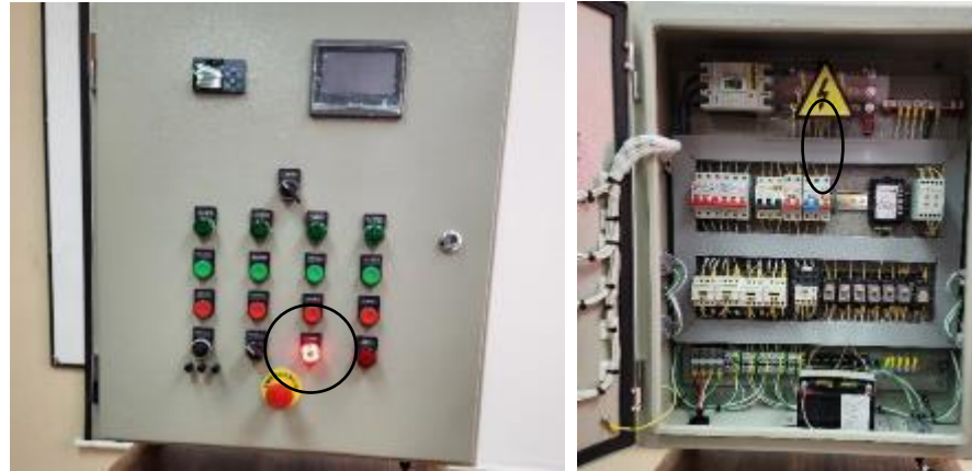
Ilustración 4-9: Funcionamiento del supervisor de voltaje
