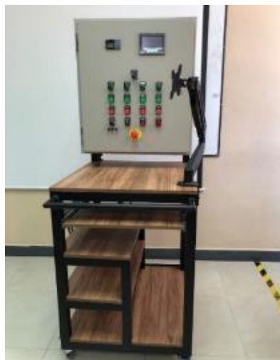
Ilustración 3-34: Sistema de control eléctrico móvil implementando en el laboratorio
