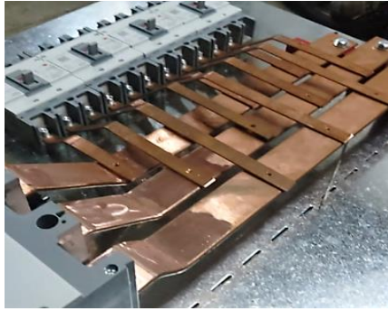
Ilustración 2-12: Barras colectoras de cobre
