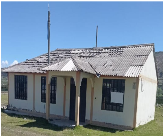
Estación ferroviaria en mal estado
