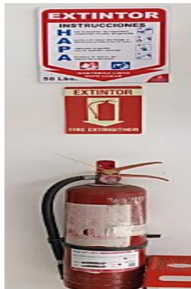
Extintor rotulado con su manual de manejo
