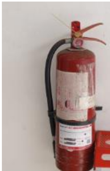
Extintor sin rotulacion y manual de manejo
