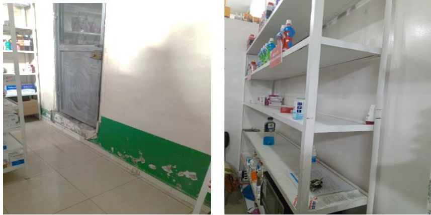
Ilustración 4-1: Paredes con humedad y estanterías unidas a la pared
