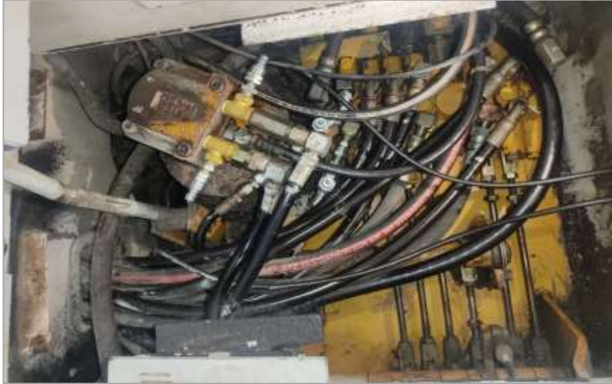
Ilustración 3-26: Grupo de válvulas terminado con sus respectivas conexiones. Realizado por: Peñafiel V. & Toaquiza G.,2024.
